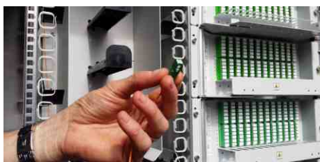
Arrivée d'une fibre dans un point de mutualisation de rue
